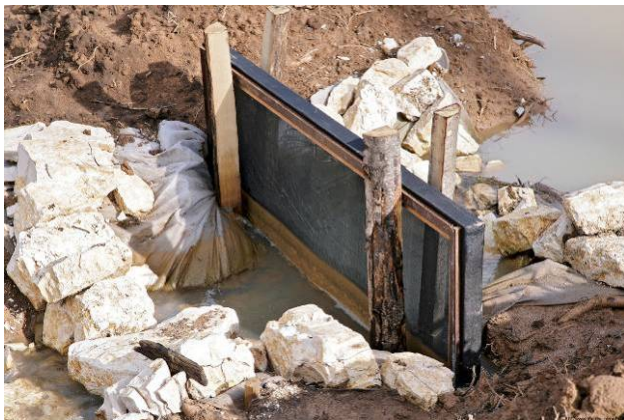
➡ Dispositif filtrant des eaux de ruissellement de chantier (cliché RFF)
