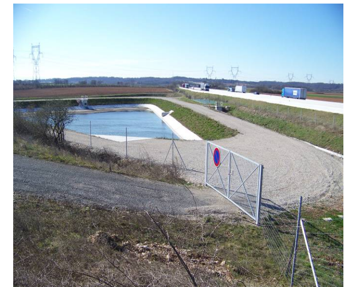
➡ Exemple de bassin de traitement
